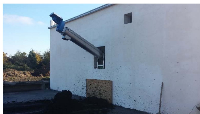
Dopravník kalové koncovky
